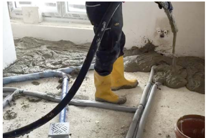
Rohre und Leitung sind für thermoplan ® kein Hindernis, sondern vielmehr Rechtfertigung für das Produkt.
